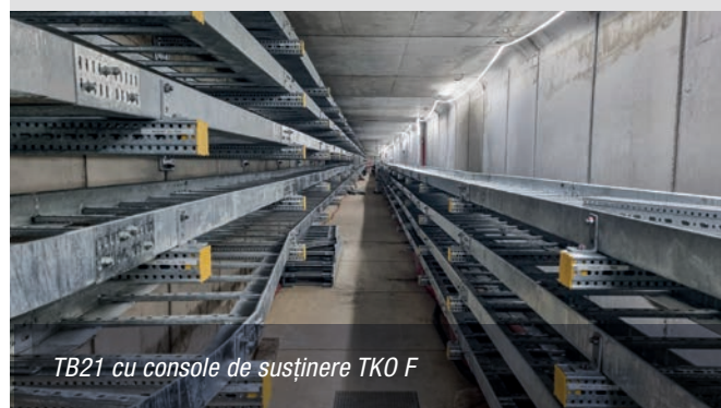
Suporturi siFramo în clădirea Tokamak
